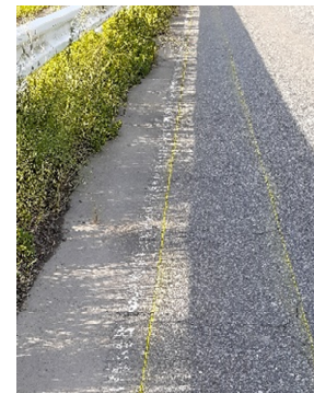
区画線の摩耗
