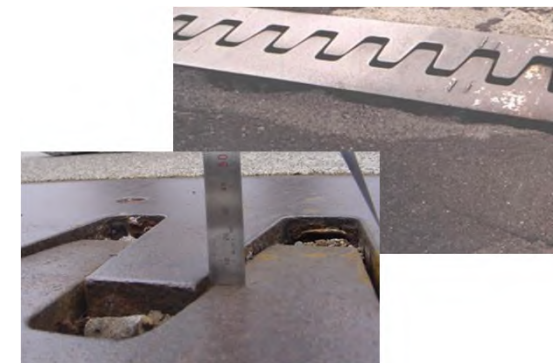
近接して計測(遊間異常、段差)
