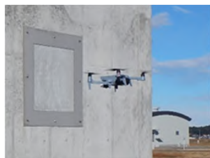
ドローンによる損傷把握
