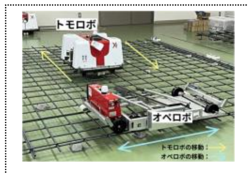
写真一 2 全自動システム
