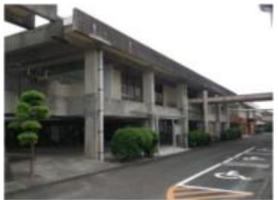
既存施設の老朽化の状況
