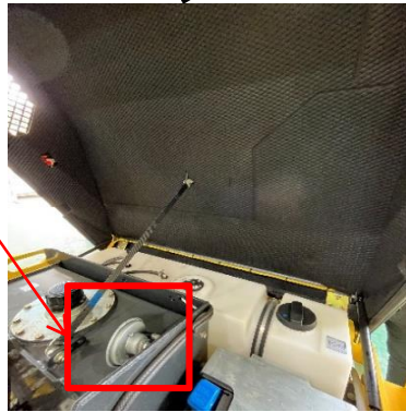
図：エンジンボンネット内の写真
