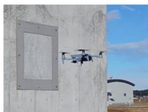
ドローンによる損傷把握
