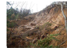
◀②H19復旧箇所の崩壊
