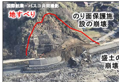
▲地すべりの影響を受けた道路
