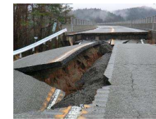
◀①能登大橋取付部の段差
