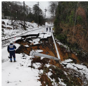
道路被害状況の調査
