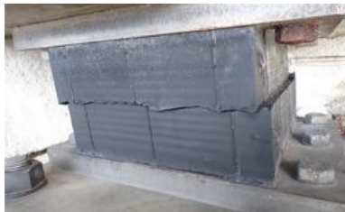
支承が破断した事例
