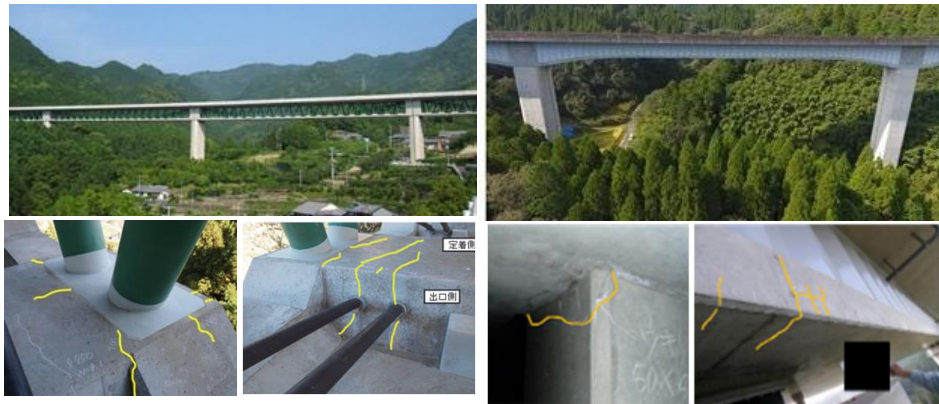
格点部の損傷
