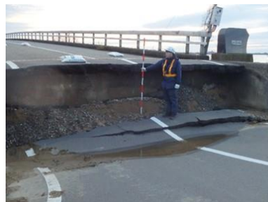
橋台背面区間に大きな段差が生じた事例
