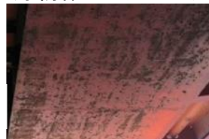
母材に錆が発生 (腐食が生じてしまう可能性あり)
