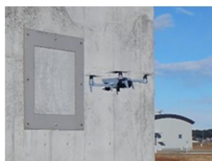
ドローンによる損傷把握
