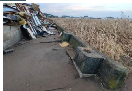
①正院地区: 護岸・水叩き損壊状況
