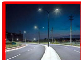
LED照明 (消費電力約56%削減)
