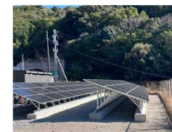
太陽光発電施設
