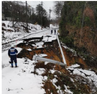
道路被害状況の調査
