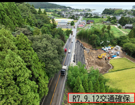
③国道249号 大雨(R7.8.6～)被災からの復旧
