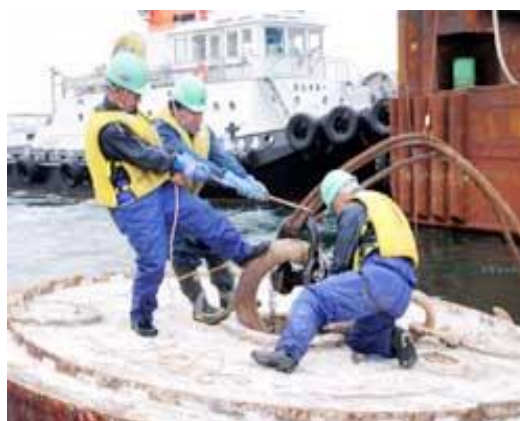
写真4：不安定な足場での繫船作業（函館港）
