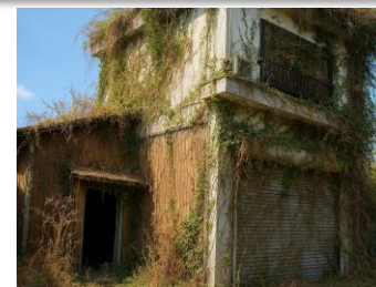
火災予防上管理が不十分な空き家(イメージ) ※蔦の繁茂、扉の破損等
