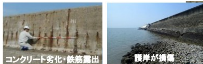
＜堤防・護岸の老朽化の状況＞
