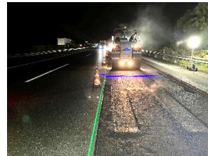
アスファルトフィニッシャーに設置
