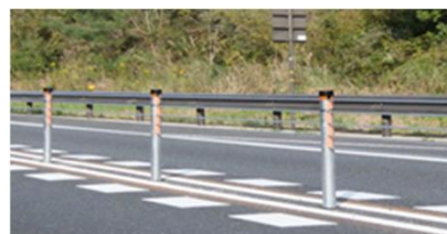
設置状況(昼間)
