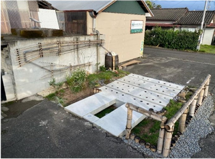
あさぎりの竹しずく（竹筋コンクリート雨庭駐車場）
