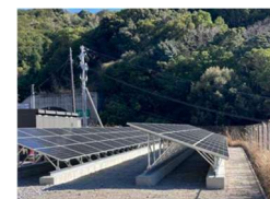
太陽光発電施設
