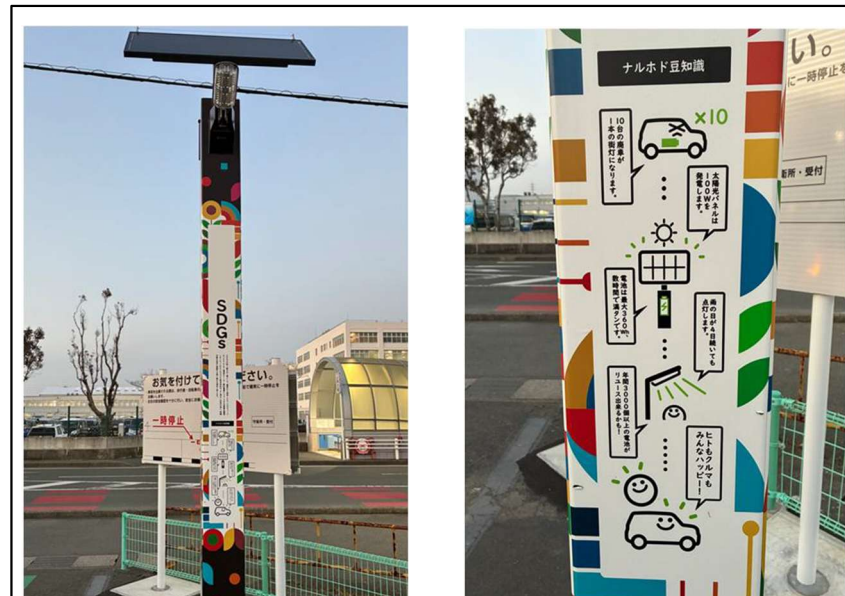
使用済みバッテリーを活用した照明灯
