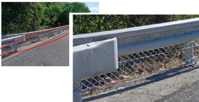
野生動物侵入防止フェンス
