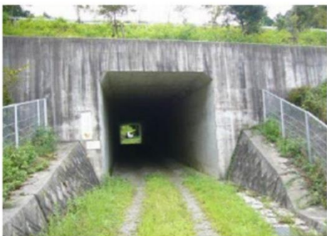
動物の移動経路確保 (道路下へのボックスカルバートの設置)
