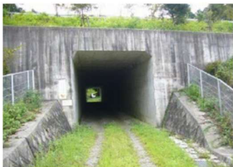
動物の移動経路確保 (道路下へのボックスカルバートの設置)
