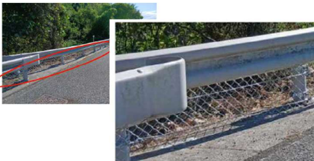
野生動物侵入防止フェンス
