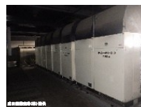
高効率型空調機
