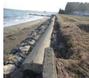
②上戸地区：護岸損壊状況
