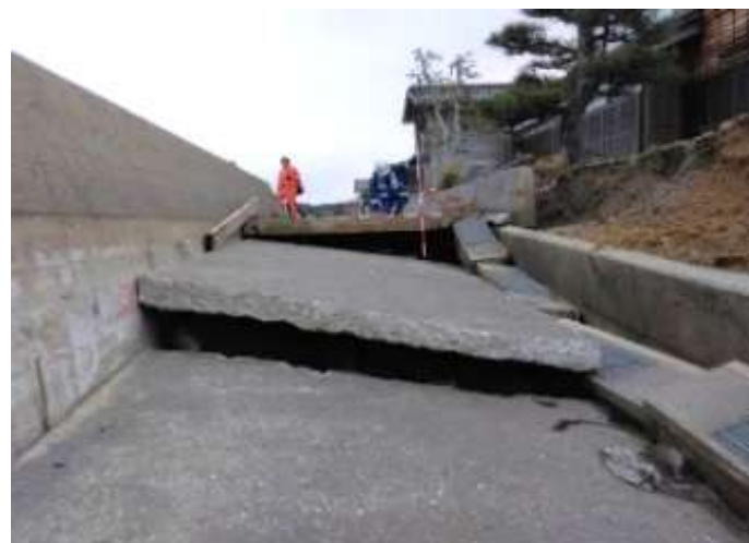
護岸・水叩き損傷
