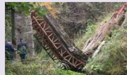
香川・徳島県境無名橋の落橋 (2007年)
