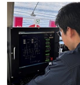
遠隔自動化システム
