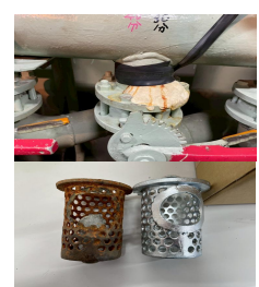
従来の海水によるエンジン冷却 (船内機器の一部に腐食が見られる)
