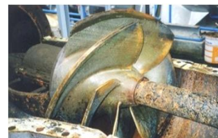
排水機場インペラの老朽化
