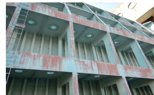
ゲート扉体の老朽化
