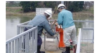
樋管の機側操作
