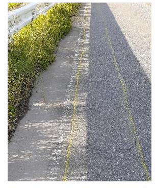
区画線の摩耗
