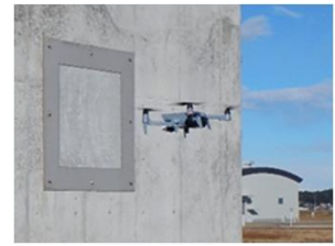
ドローンによる損傷把握
