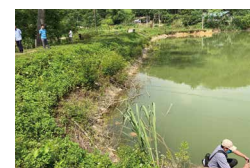
改修前のケオ・コイ貯水池の堤体は、漏水によって貯水能力が低下していた。
