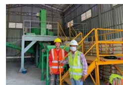
カンボジアに据え付けた土壌硬化剤の製造設備。
