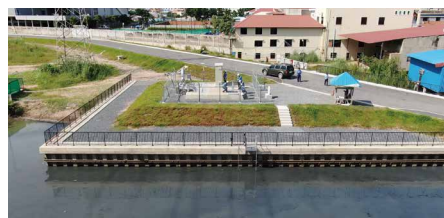
取水ポンプ場。
