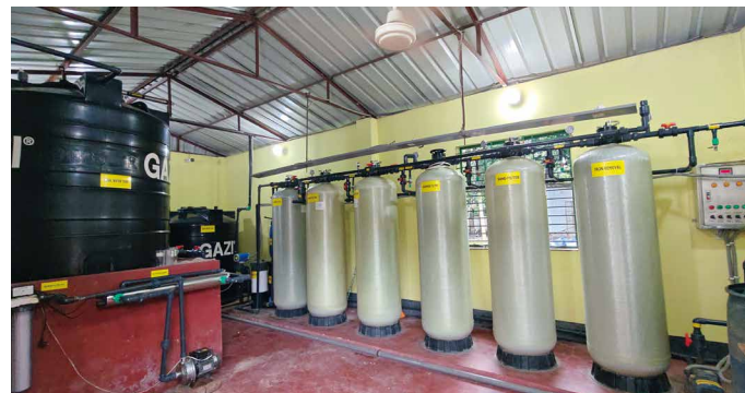
散在村落に設置された処理設備。複数の処理塔を組み合わせ、原水の入力から処理水の貯留・供給まで、一連の浄水工程を構成している。
