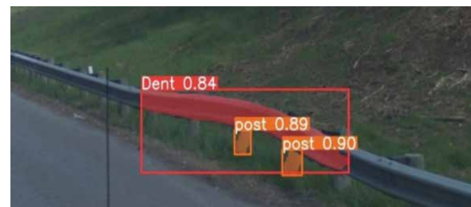
路面状態、標識、ガードレール、ポットホール等を自動的に検知。
