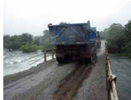
幅員の狭い旧スンバ橋を通行する大型車両。 老朽化と車両の大型化により落橋の危険性が高まり、片 側交互通行を余儀なくされたことから、交通のボトルネック となっていた。
