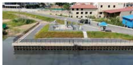
取水ポンプ場。
