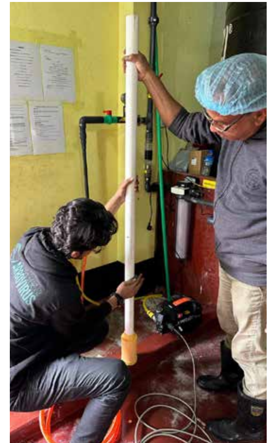
浄水設備の配管や処理塔の状態を確認し、安定した運転を維持するため、現地で点検・メンテナンスを実施している。
