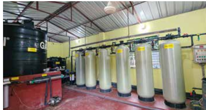
散在村落に設置された処理設備。複数の処理塔を組み合わせ、原水の入力から処理水の貯留・供給まで、一連の浄水工程を構成している。
