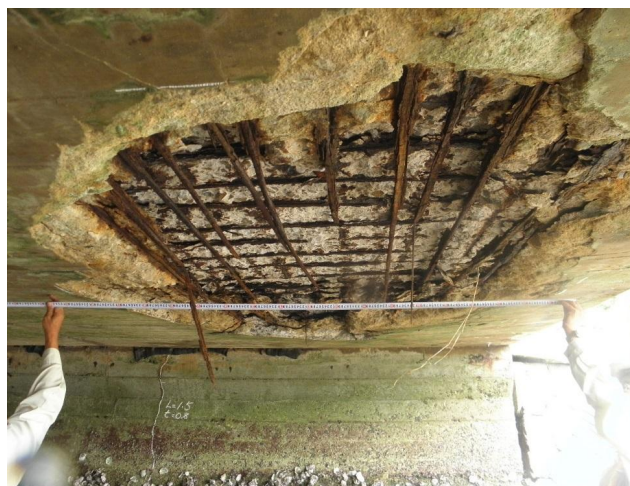
地方自治体管理 床版鉄筋露出
