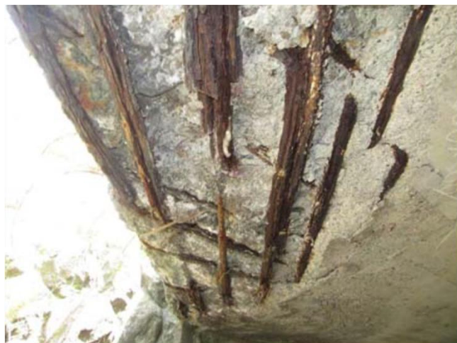
国管理 床版鉄筋露出 ※床版: 橋の裏側
