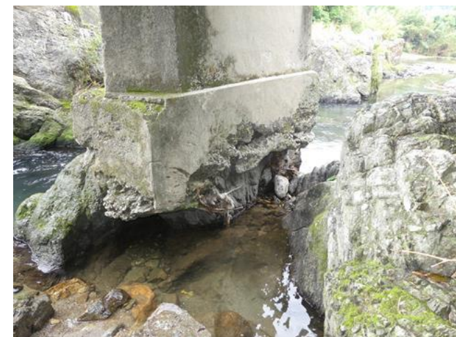
地方自治体管理 橋脚洗掘
