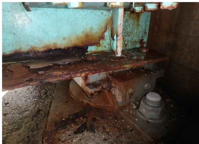
地方自治体管理 主桁腐食
