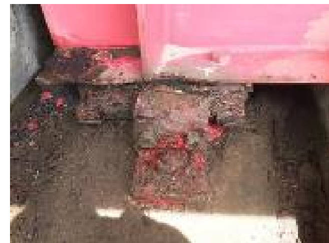
地方自治体管理 支承腐食
