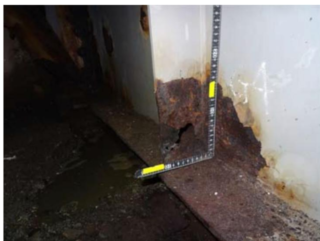
国管理 主桁腐食・欠損
