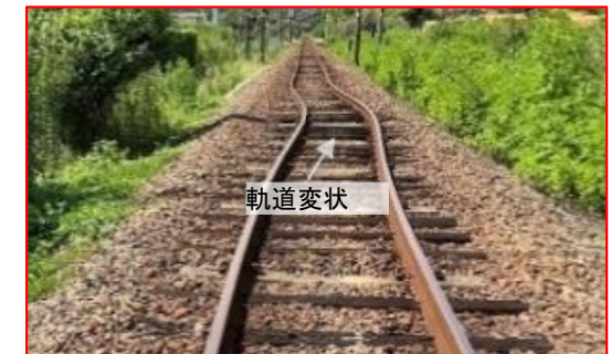
肥薩おれんじ鉄道 （肥後高田～日奈温泉間） 軌道変状
