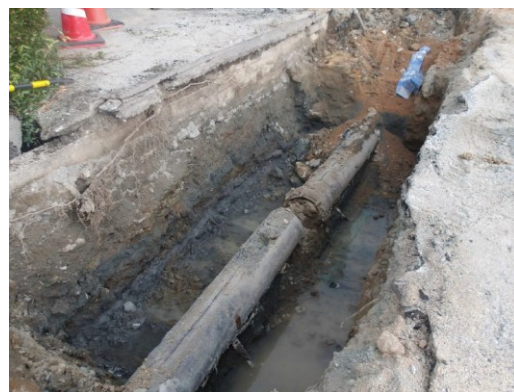
水道管の被害
