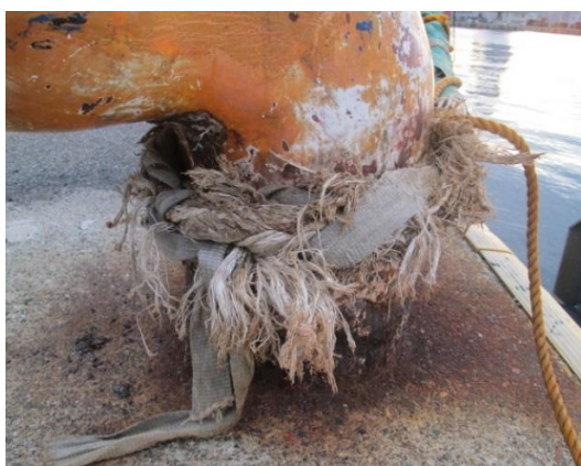
写真7：劣悪な係留ロープ
