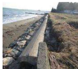
②上戸地区：護岸損壊状況
