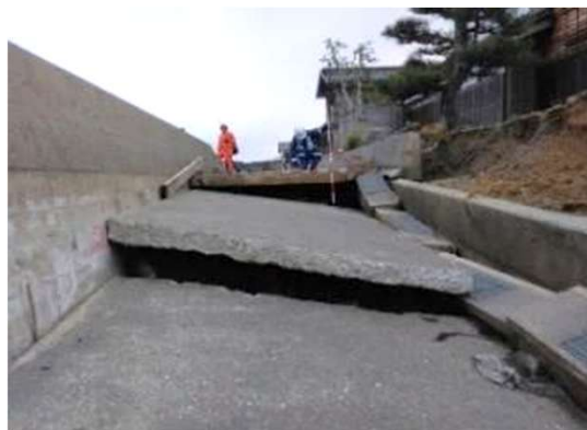
護岸・水叩き損傷
