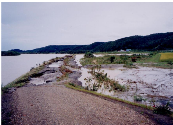
春日管理用道路被災状況
