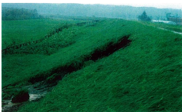
米原築堤被災状況
