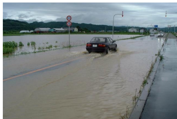
主要道道穂別鵒川線浸水状況
