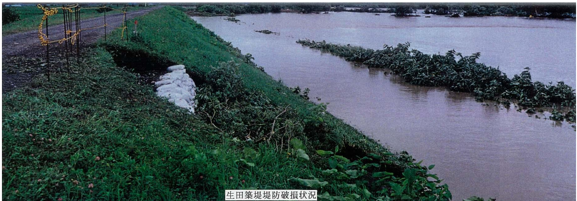
生田築堤堤防破損状況 生田築堤堤防破損状況
