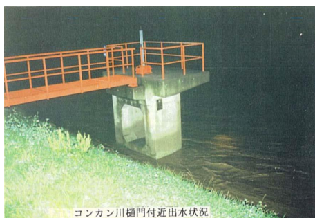
コンカン川樋門付近出水状況
