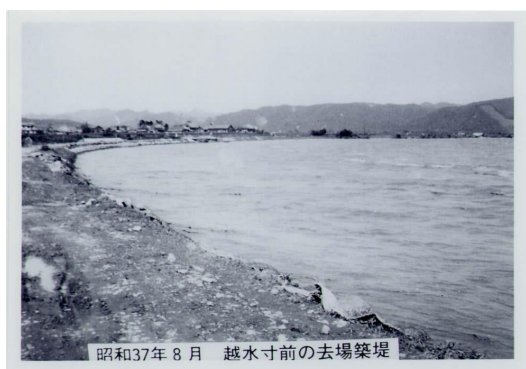
越水寸前の去場築堤
