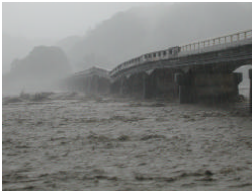
竜西橋陥没 (安倍川 19.5k 付近)
