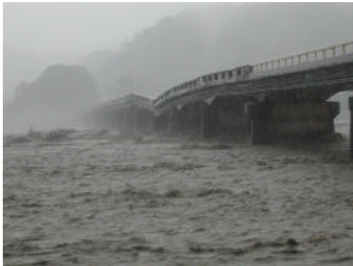
竜西橋陥没 (安倍川 19.5k 付近) 平成 13 年 8 月洪水、平成 14 年 7 洪水 では、昭和 10 年に建設された竜西橋が陥 没した。
