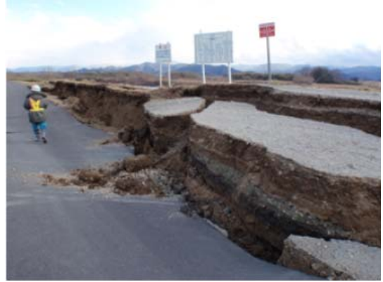
阿武隈川右岸 31.0k 付近 （角田市枝野地先） ※地震による堤防沈下
