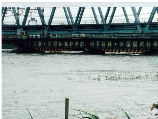
写真 4-12 形成押上線橋梁の洪水写真
