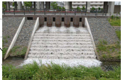
写真 6-3 菖蒲川・笹目川等 浄化導水事業放流状況
