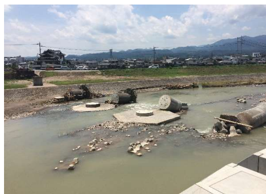
倒壊した J R 鉄道橋 （日田市）
