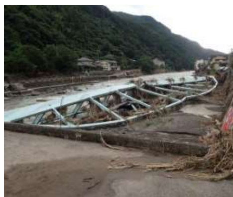
洪水により流失した玖珠川の橋梁 （日田市）
