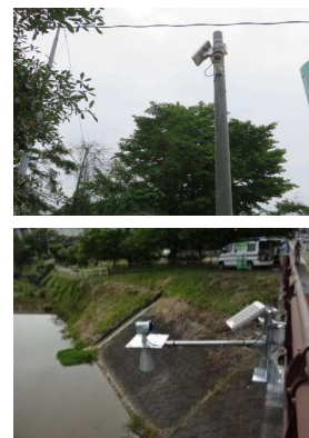
図 4-12 危機管理型水位計、簡易型河川監視カメラの増設
