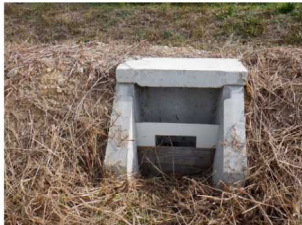
田んぼダムの排水柵
