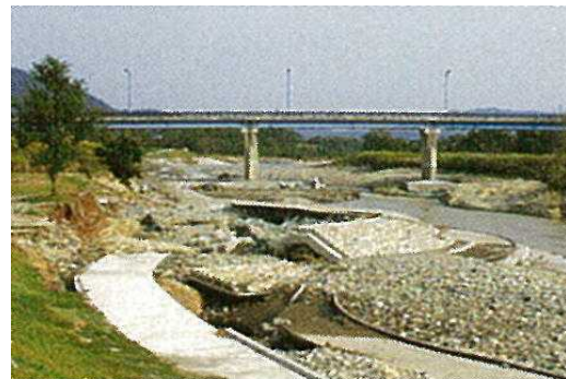
長尾護岸崩壊 (平成16年10月台風第23号洪水)
