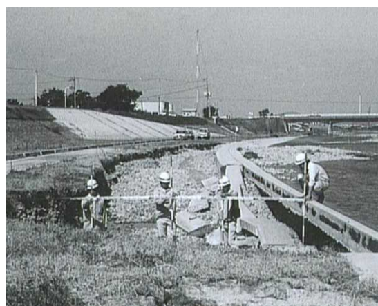
河岸被災状況
