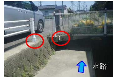
浸水センサ設置状況
