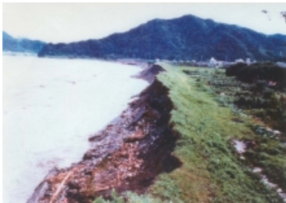
昭和57年洪水(破堤寸前の堤防浸食)
