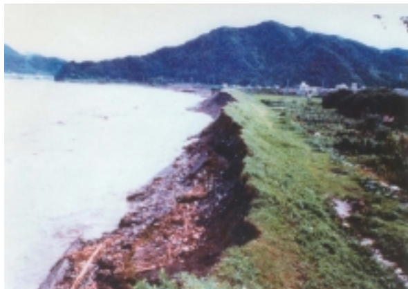
◆昭和57年洪水（破堤寸前の堤防浸食）
