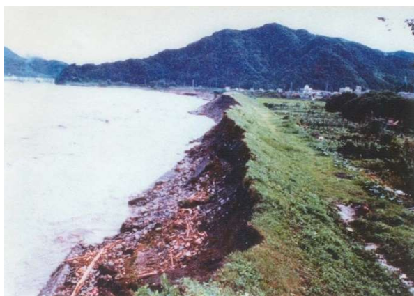
写真 4-8 昭和57年（1982年）洪水（破堤寸前の堤防侵食）
