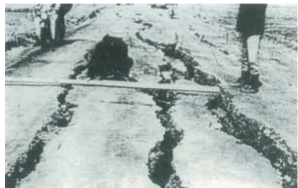
【写真】十勝沖地震被害状況 馬淵川堤防天端の亀裂
