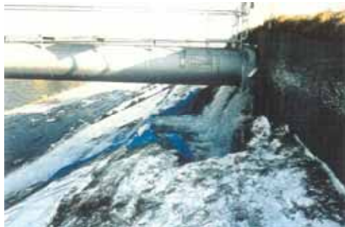
【写真】三陸はるか沖地震被害状況 水管橋の被害
