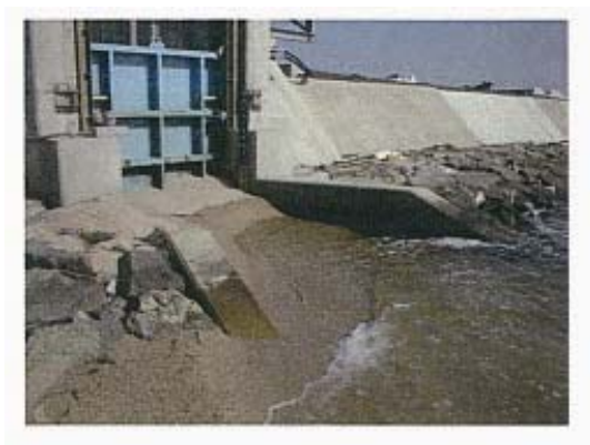
樋門吐口の土砂堆積状況
