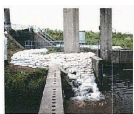
樋門部からの漏水事例
