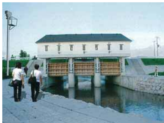
図－9.5 樋門付近の CCTV 監視カメラ
