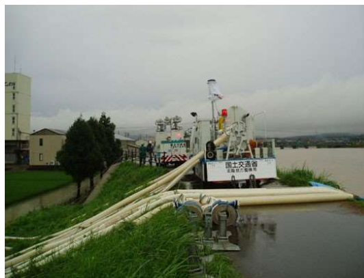
図 9-8 川田川樋管排水ポンプ車
